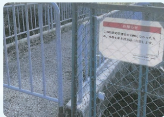
大阪府から突然封鎖された橋(24橋)
